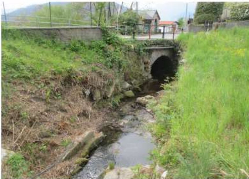
difesa spondale ammalorata nei pressi del ponticello di via Venezia, con particolare della tratta con conci mancanti al piede
