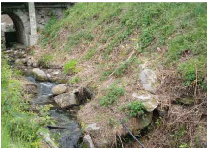
Tratta a valle del ponticello di via Francioli, priva di muro spondale
